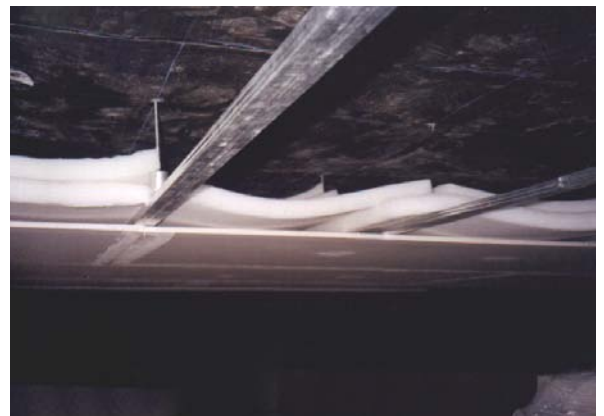
Techo aislante con PKB-2.
