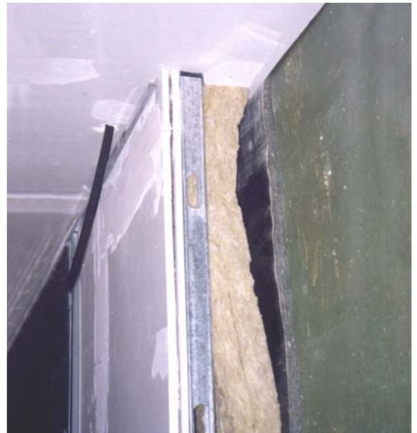
Trasdosado aislante con PKB-2.
